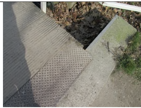
Foto 8: Overgangsplaten H49 liggen los.
