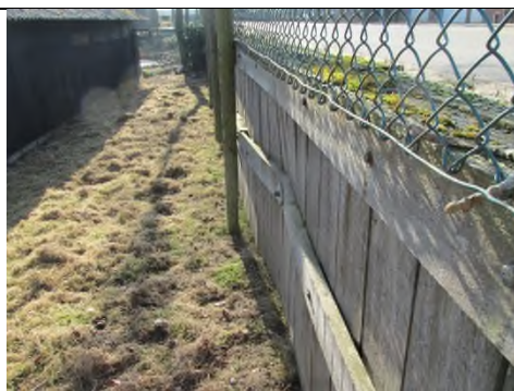
Foto 11: De gording is zwaar vervormt. De weg en berm direct achter de damwand is zichtbaar.
