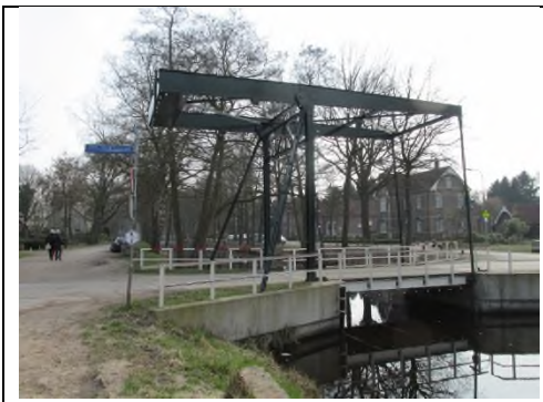
Foto 7: het val ligt niet volledig op.
