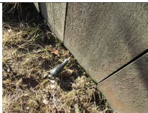
Foto 12: De damwand zijn ter hoogte van het maaiveld plaatselijk geheel rot.
