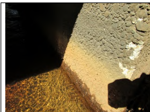
Foto 9: Het beton op de waterlijn is uitgewassen S16.
